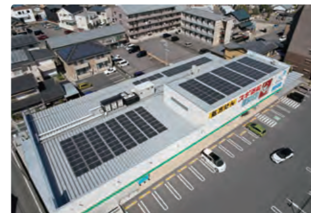
店舗の屋上に設置した太陽光パネル
