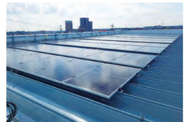
愛知県刈谷市富士見店の屋上に設置した太陽光パネル
